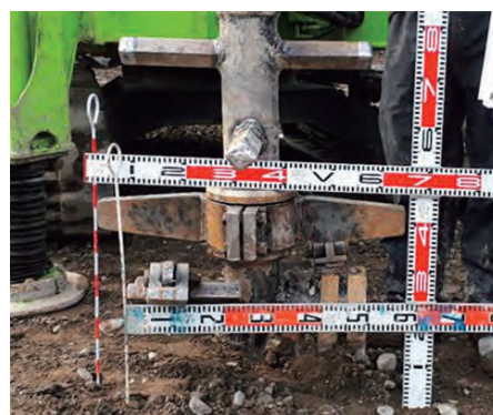
写真-1 攪拌混合装置
