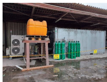
写真-1 炭酸化養生槽の例
