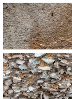
写真-5 壁面の劣化状況
