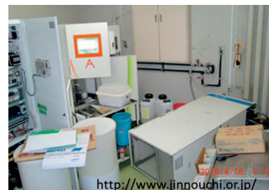
図-2 透析機械室の被害 3)
