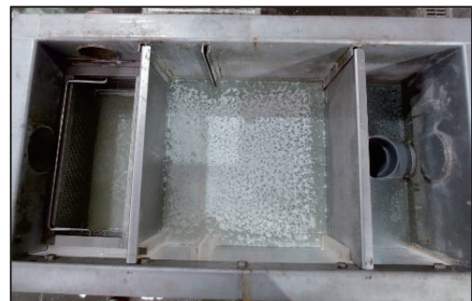
写真-2 実験後の阻集器内の状況(条件C)
