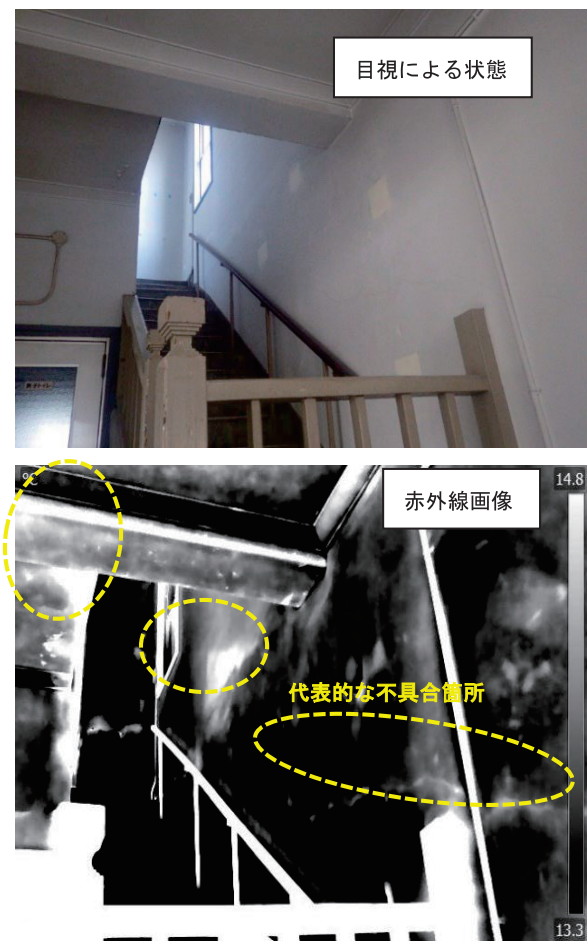
写真-4 アクティブ法による赤外線測定 (室内側から東面外壁)
