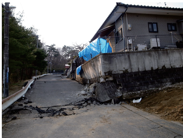
写真-1 2011年東北地方太平洋沖地震による谷埋め盛土末端の宅地崩壊（仙台市青葉区）
