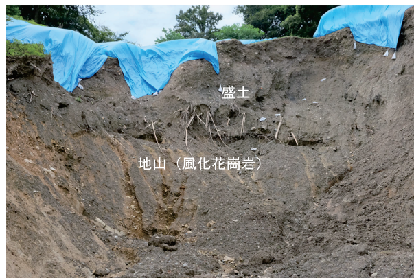
写真-2 崩壊した谷埋め盛土（残土盛土）底面に見られる地下浸食の痕跡（空隙が連続する部分）
