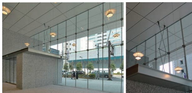
写真-38 ケーブルグリッドにおける補剛ケーブル
