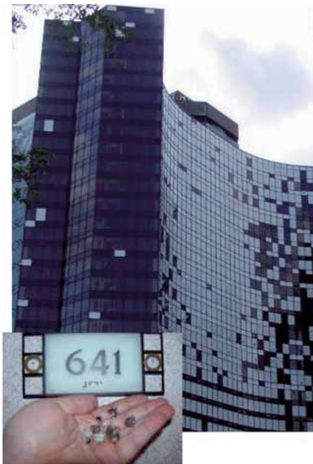
写真-10 ハリケーン・カトリナによるニューオリンズ市内の高層ホテルの窓の被害（部屋では、飛散してガラスに衝撃を与えた碎石が見つかった）。
