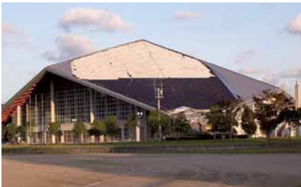
写真-6 瓦棒ふき鉄板屋根の熱伸縮による強風被害
