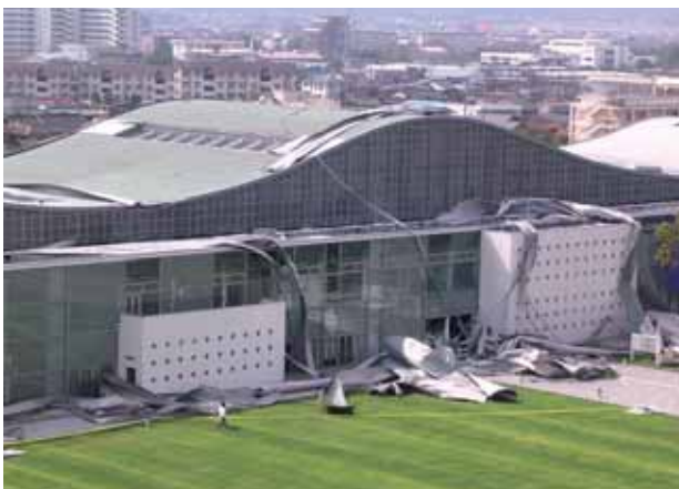
写真-7 屋根ふき材の熱伸縮も原因の一つと考えられる山口情報芸術センターの被害（山口大学藤川氏提供）
