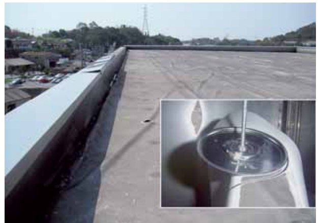
写真-8 防水シートの被害。固定部の接着剤が熱剥離していたことが原因。（大牟田市内の工場）
