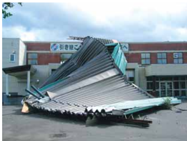
写真-4 置き屋根の被害 (江別市提供)
