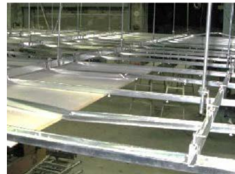
b) 耐風圧クリップを用いた場合の天井板の落下
