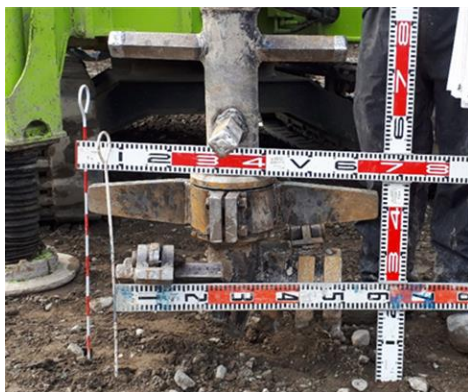
写真1 攪拌混合装置
