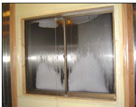
サッシの結露発生状況
