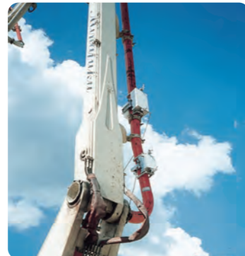
工事現場におけるフレッシュコンクリートの単位水量自動計測
