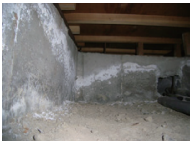
写真-4 住宅基礎の硫酸塩劣化状況
