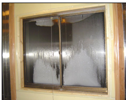
サッシの結露発生状況
