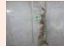
建設中の不具合例
